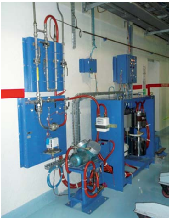
Chaîne de mesure bêta gaz à la cheminée : centrale du Bugey.
