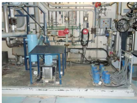
Puisard RPE de collecte des purges du circuit primaire : centrale du Bugey
