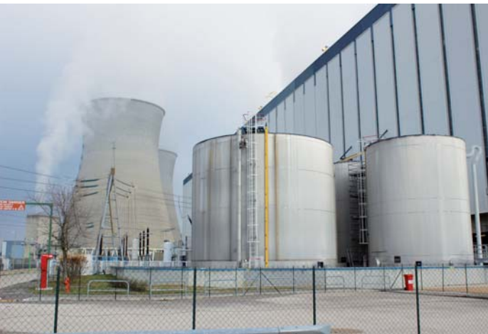
Réservoirs Ex et leurs cuvelages de rétention : centrale du Bugey
