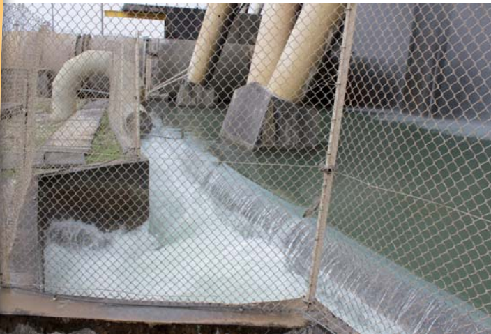
Purge d'un aéroréfrigérant
