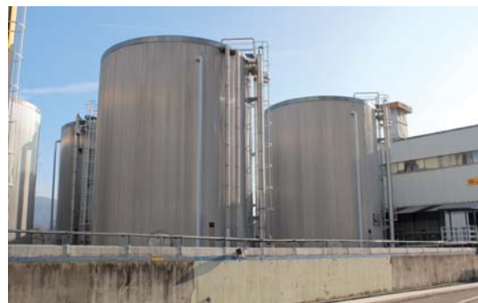
Réservoirs T et S d'entreposage des effluents avant rejet et leurs cuvelages de rétention : centrale du Bugey.
