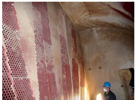
Plaques tubulaires de condenseurs.
