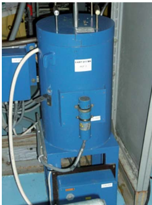
Chaîne de mesure de radioactivité gamma globale sur la canalisation de rejet.
