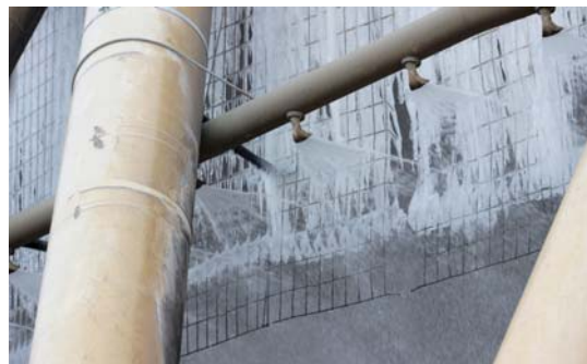
Systeme de lutte contre la prise en glace d'un aéroréfrigérant
