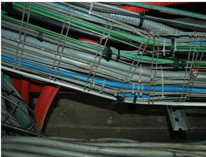
Figure 7.1. Exemple de chemin de câbles dans une installation. © Georges Goué/IRSN.
