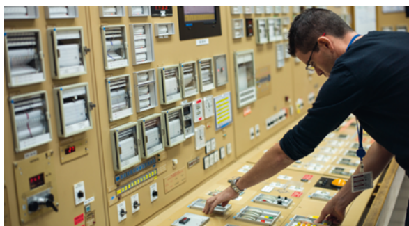
Salle de commande de la centrale nucléaire de St-Alban (2 x 1300 MWe en bordure du Rhône) © EDF – Christel Sasso
