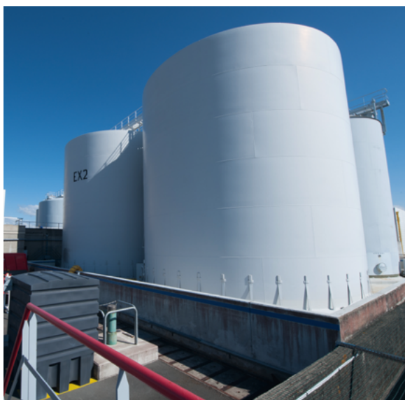
Réservoirs Ex et leurs cuvelages de rétention : centrale du Blayais © EDF – Gabrielle Balloffet
