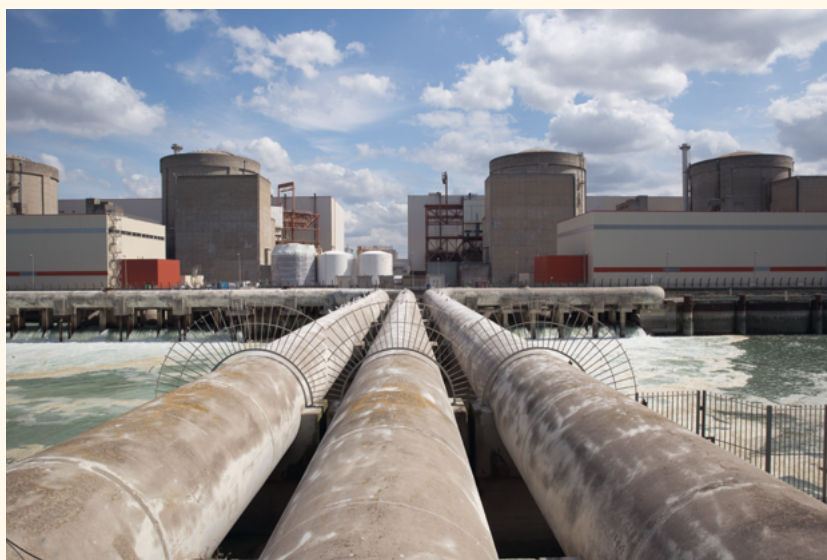
Conduites d'amenée d'eau tiède depuis le CNPE de Gravelines vers la ferme aquacole voisine © EDF – Bruno Conty
