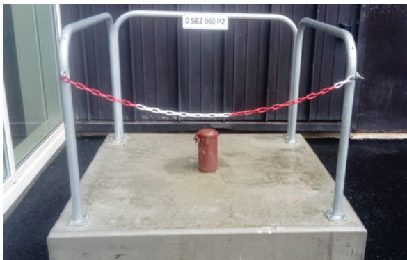
Exemple de piézomètre installé au CNPE de Flamanville 3 – © Envisol
