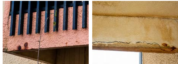
Coulures de produits de corrosion
