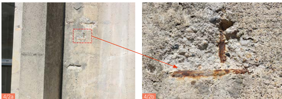
Photo 4/2 : Extrait de relevés et d'observations d'un réservoir d'eau présentant de la corrosion suite à une carbonatation du béton (a) et focus sur les aciers (b) (setec lerm)
