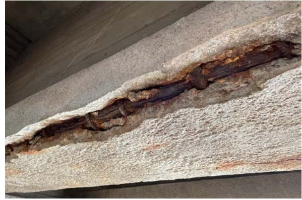
Photo 7/5 : Disparition des cadres par corrosion (E. Ferrier, Université Lyon 1)
