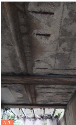
Photo 2/24 : Corrosion d'un château d'eau (J-F. Seignol, Université Gustave Eiffel)
