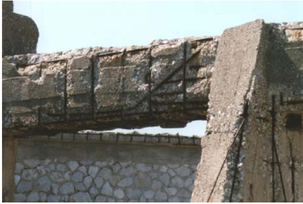
Photo 7/4 : Disparition des cadres par corrosion (E. Ferrier, Université Lyon 1)
