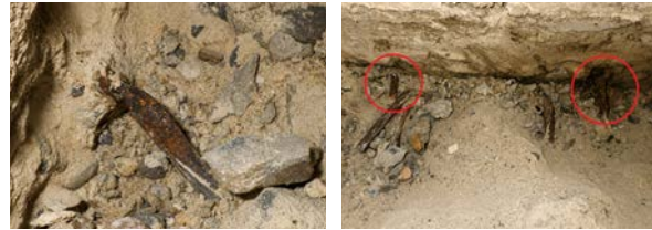
Aciers dissous et sectionnés à la jonction dalle – garde-corps
