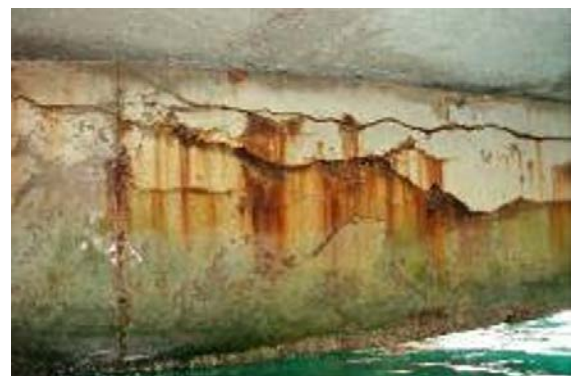
Corrosion par les ions chlorure
